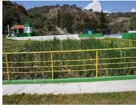
Figura 7a. PTAR rehabilitada y operada por DUMAC en la comunidad de Rosa de Castilla del municipio de Copándaro.
