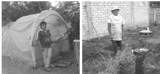
Figura 7. Biodigestores instalados. Del lado izquierdo se puede apreciar el biodigestor para estiércol que tiene captación de gas metano. El biodigestor del lado derecho es para uso sanitario.
